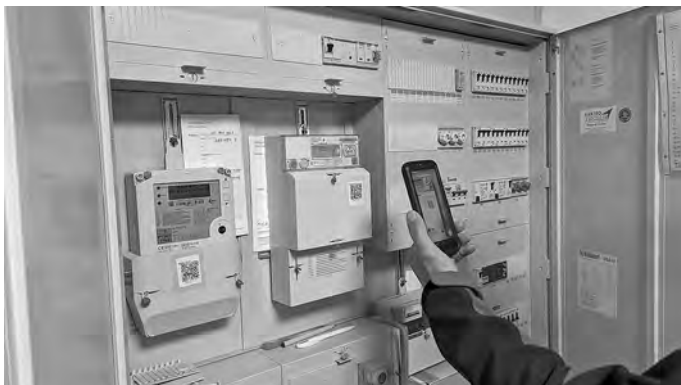
Ein Energiemanager beim Erfassen der Zählerstände an einem Zäblerschrank
