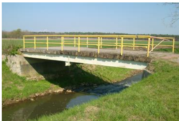
nach Hochwasserereignis Juni 2013
