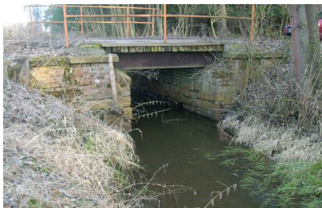
nach Hochwasserereignis Juni 2013
